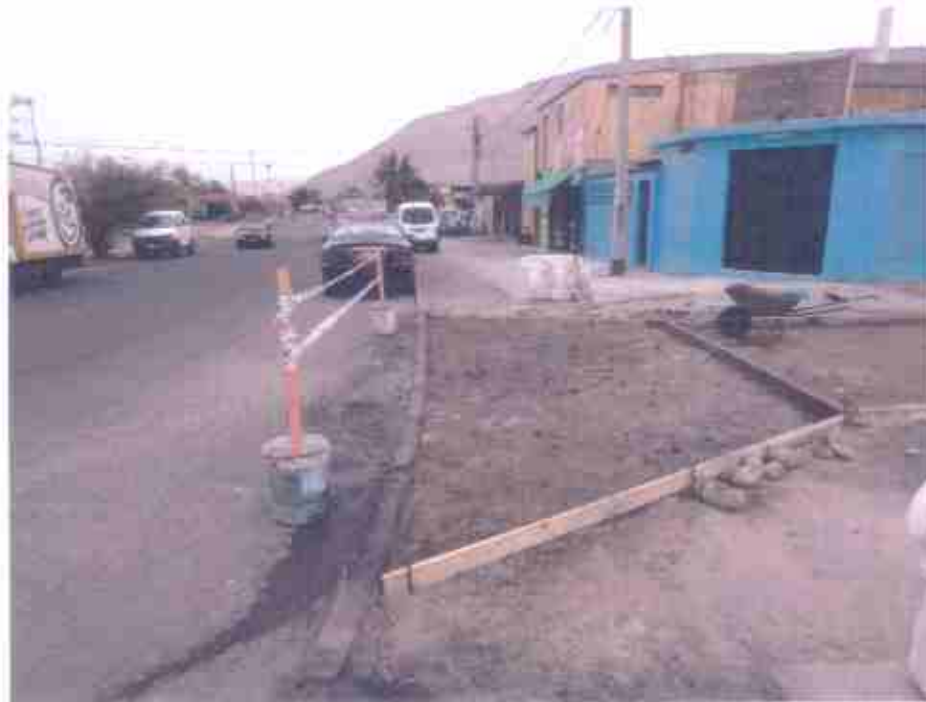
Fotografía N° 5, base estabilizada, pasaje Los Espinos (Barros Luco – Los Avellanos), 26 de octubre de 2015.
