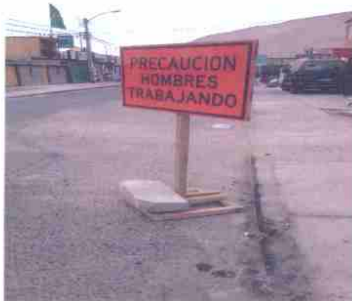
Fotografía N° 3, señalización provisoria población Cabo Aroca, 29 de octubre 2015.
