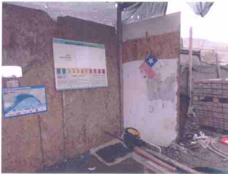
Fotografía N° 15, tabla sin señalización del nivel de radiación UV, 26 de octubre de 2015.
